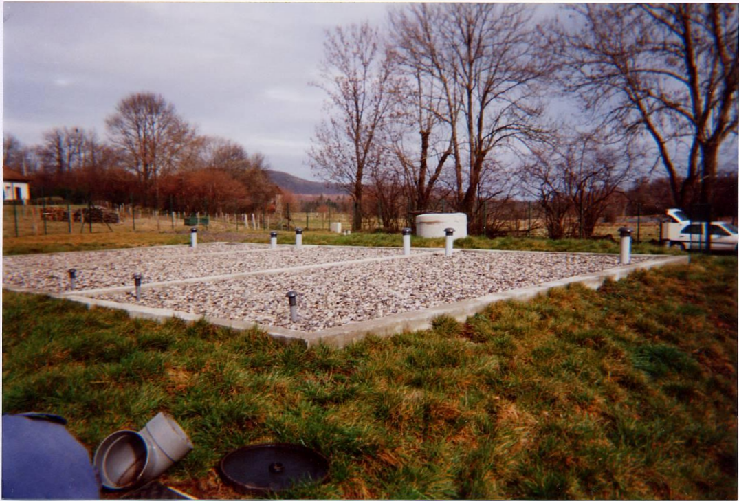
3 filtres à sable
