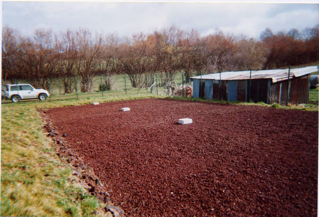
Finition de l'épuration par épandage sur pouzzolane
